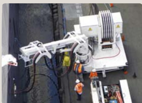
Ett mobilt AMP-system som levererar landström vid Port of Los Angeles
