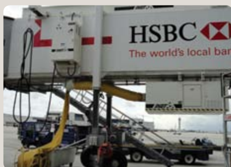
Centraliserat förkonditionerat luftsystem
