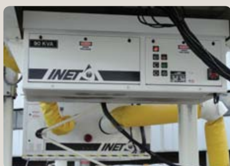
Rampmonterad 400Hz static converter i drift på en flygplats i USA
